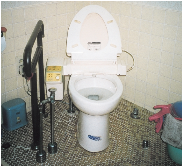
写真5：片側の手すりを外したトイレ (手すりが固定式のため便器へのアプローチの邪魔になる。手すりの内側に見える洗浄ボタンは、入居者には押しにくい。)
