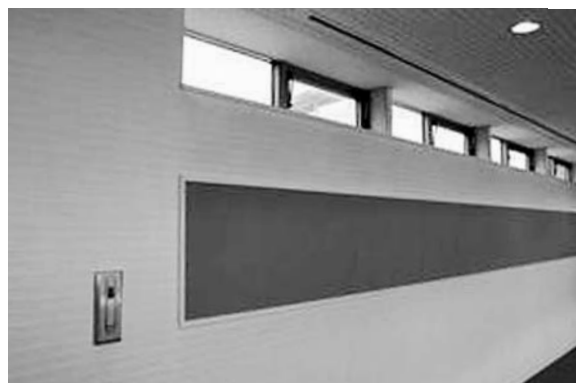
写真2 排煙装置(排煙窓)
