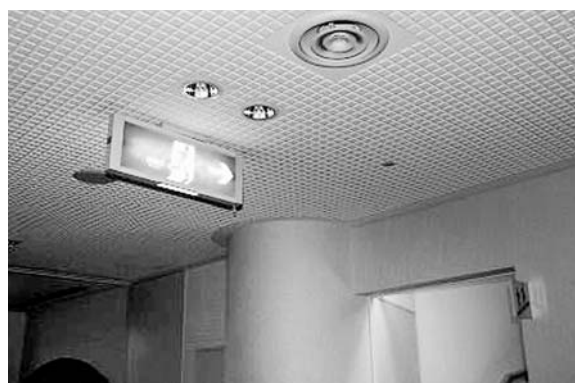
写真4 誘導灯(階段への入口)
