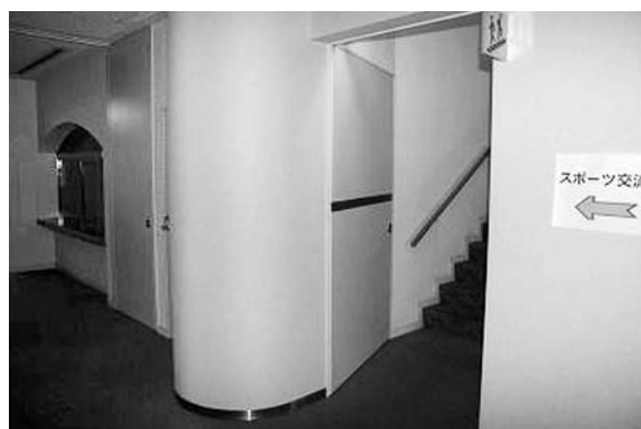
写真3 防火区画(階段の防火戸)
