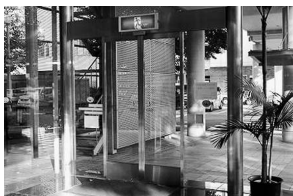
写真5 誘導灯(屋外への出口)
