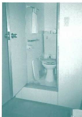
図2-a トイレの入口の段差
