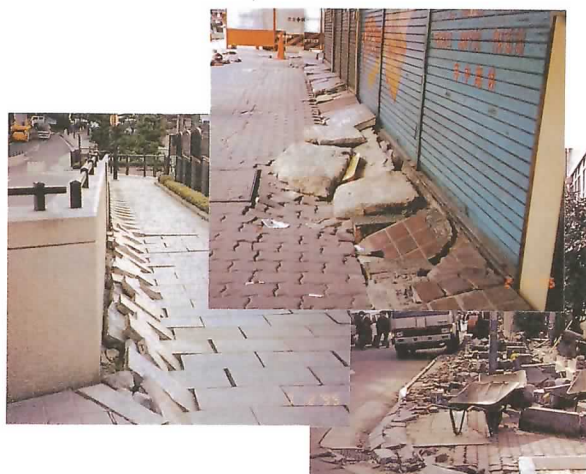
図4 震災で破損したインターロッキング舗装
