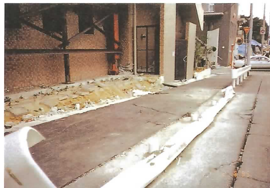
図5 ひびが入った程度のアスファルト舗装
