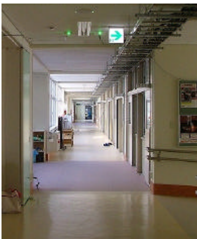
図1 ドア開閉状態表示器（写真上部の蛍光灯の左右に設置している）
