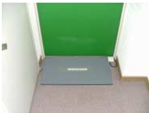
図9 非常口用のマットセンサ Fig.9 Mat switch system for emergency exit
