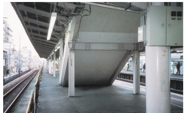
図5 階段の下に誤って入り込まないように区切っていないため視覚障害者が誤って頭をぶつける恐れがある事例
