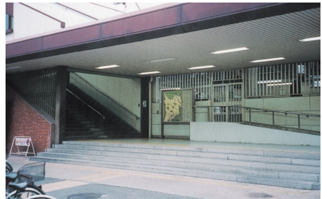
図4 短い階段において手すりが設置されていない事例
